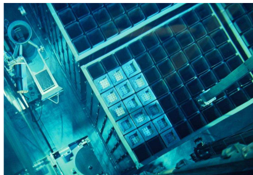
Piscine de refroidissement (EDF Belleville)
