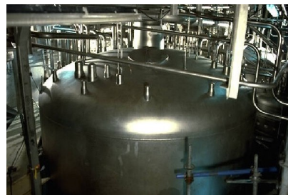
Cuve en acier inoxydable contenant les solutions molybdiques de produits de fission
