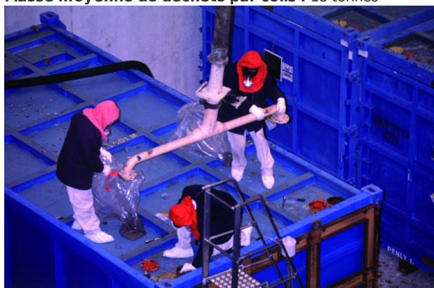
Injection interne d'un rack de Penly
